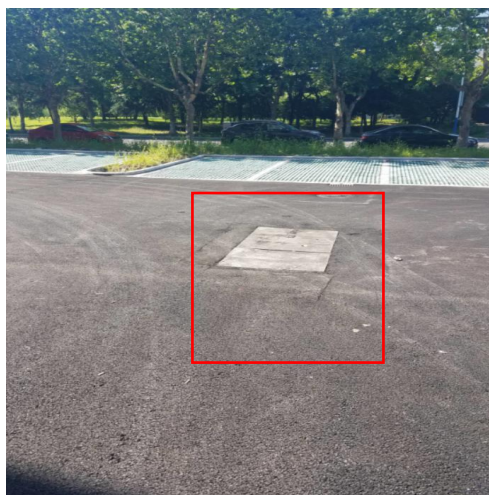
项目废水汇入校区污水管网排放口（A座北侧）
