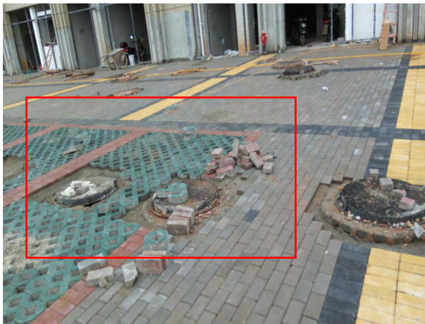
20#住宅楼北侧湾址路化粪池
