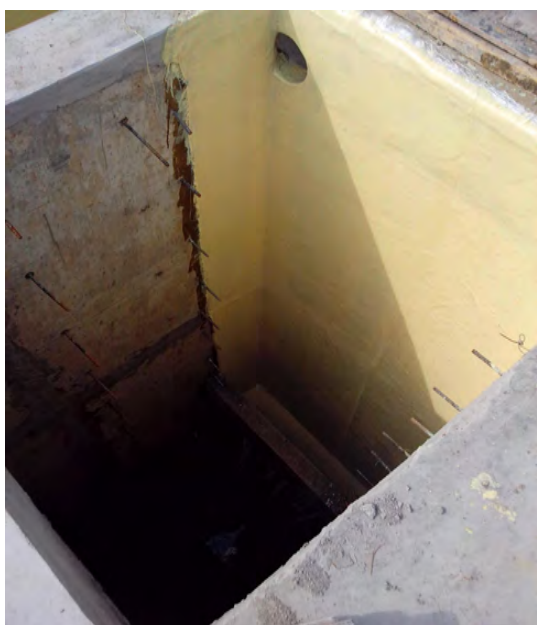
污水处理站水池的防渗
