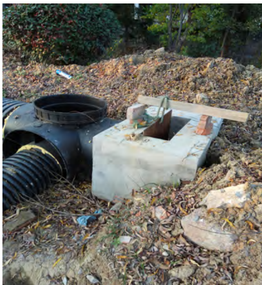
雨污管线切换阀
