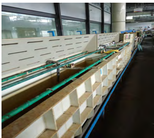
电镀线槽边抽风系统
