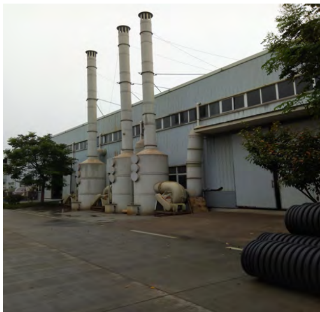
酸雾喷淋循环洗涤吸收塔
