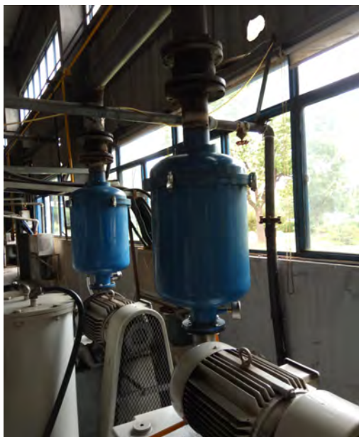
烧结炉自带空气过滤净化装置
