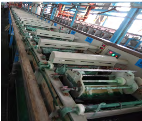
电镀线槽边抽风系统
