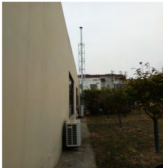
油烟废气排气筒
